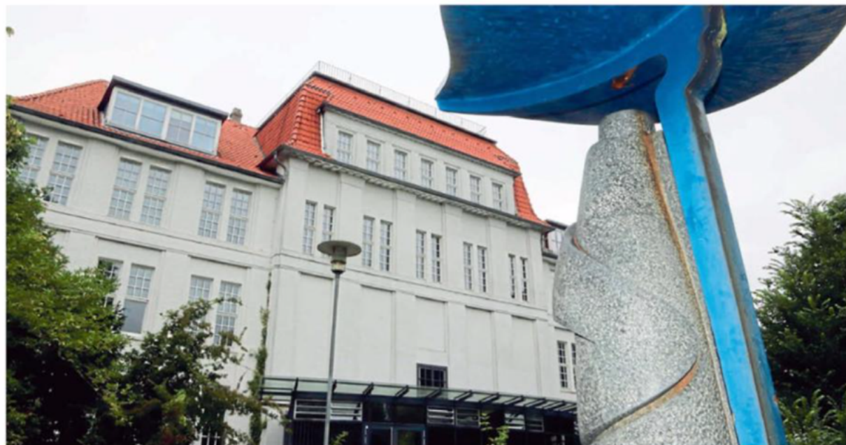
Eine Sanierung ist fällig: Um das Gebäude zu erhalten, müssen die Fenster instand gesetzt werden. Hier ein Blick auf die rückwärtige Fassade des Technikums mit dem Haupteingang. FOTO: KNUT DINTER
